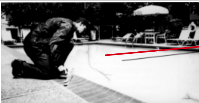
До: Безобразные трещины и утечки.
